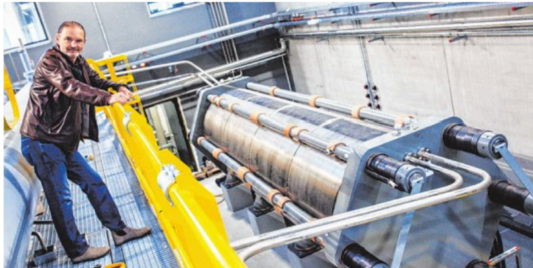
Projektleiter Ewald Perwög vor dem Herzstück der Wasserstoff-Produktionsanlage, dem Elektrolyseur. Foto: MPreis
